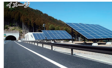
太陽光発電設備
