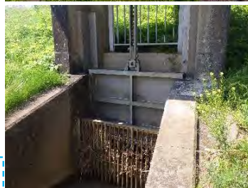
↑ 排水樋管の操作訓練状況
