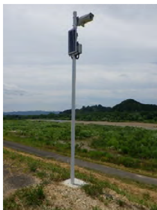
簡易型河川監視カメラ設置状況
