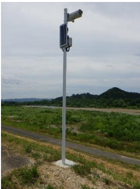
簡易型河川監視カメラ設置状況
