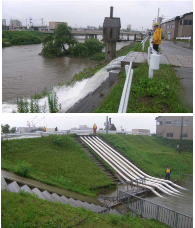
排水ポンプ車による排水状況（大仙市浜町地区）
