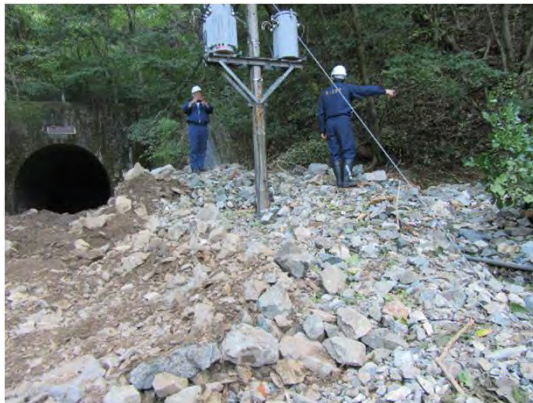
被災した鉄道施設の確認
