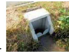
流量調整板：V字カット (横手市浅舞北部地区)
