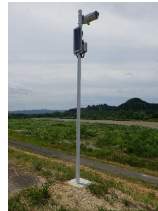
簡易型河川監視カメラ設置状況
