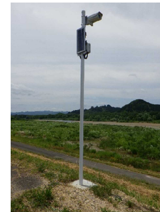
簡易型河川監視カメラ設置状況
