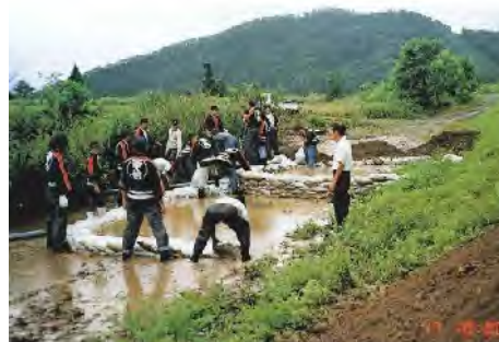
漏水被害の状況 (秋田県大仙市 やりみない 鍵見内地先)
