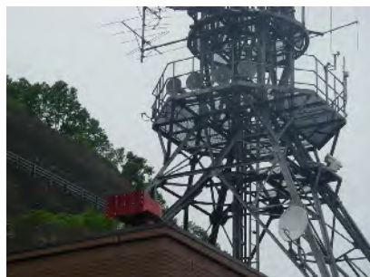
玉川ダム 放流警報施設
