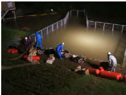
浜町排水ピット
