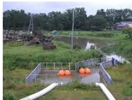
角間川排水ピット
