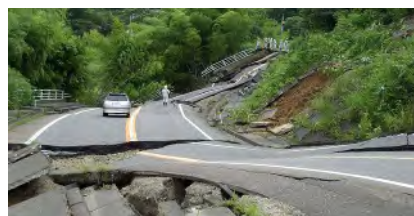
被災状況調査
