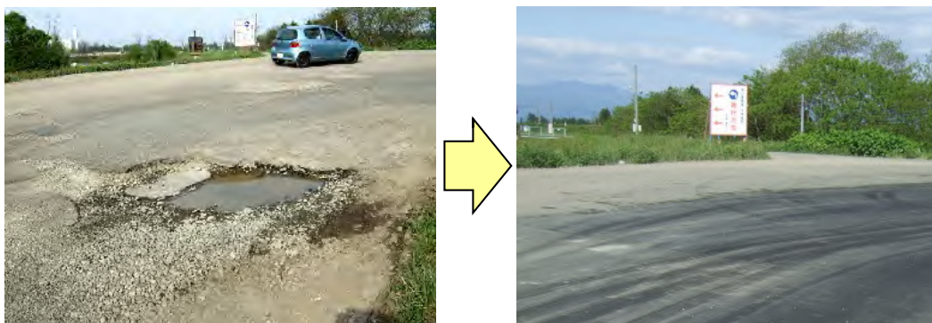
堤防の天端舗装補修前の状況
