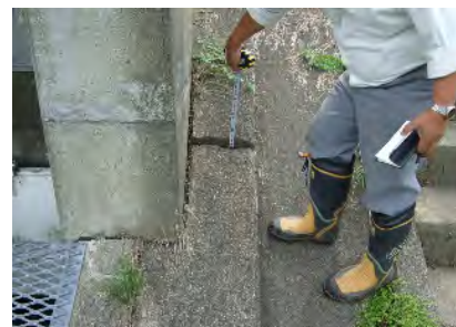
樋門・樋管の変状状況
