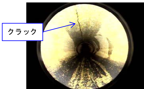
日常点検が困難な小口径樋管の変形状況
