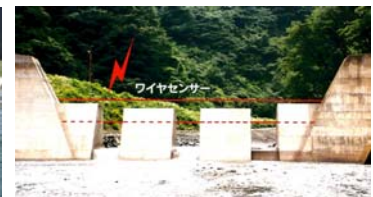
土砂移動検知センサー
