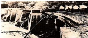
田沢湖線被害状況（昭和35年）
