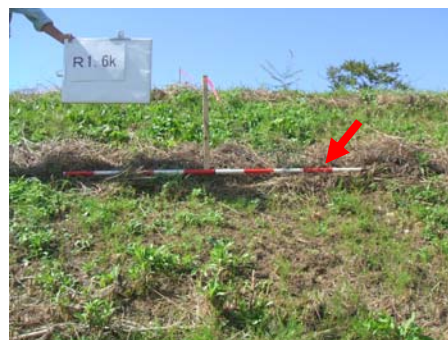
洪水痕跡調査の状況
