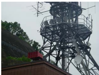
玉川ダム 放流警報施設
