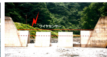
土砂移動検知センサー
