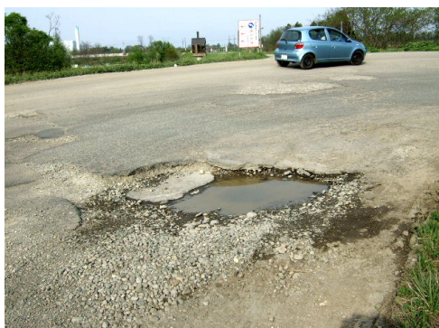
堤防の天端舗装補修前の状況
