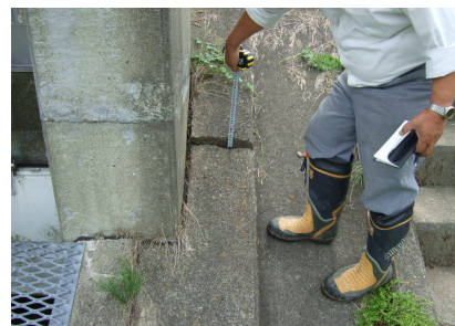
樋門・樋管の変状状況
