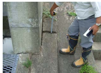
樋門・樋管の変状状況
