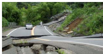
被災状況調査
