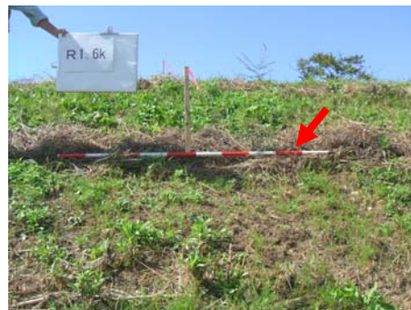
洪水痕跡調査の状況
