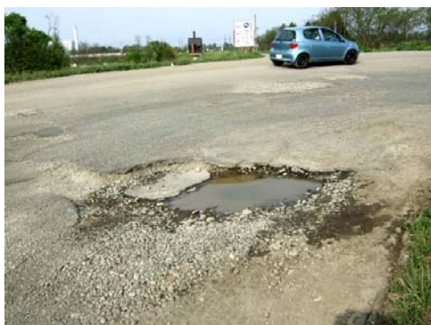
堤防の天端舗装補修前の状況
