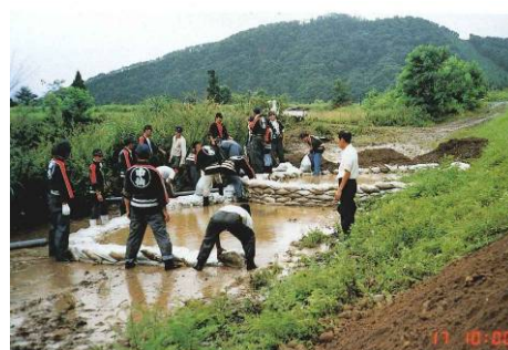
漏水被害の状況 (秋田県大仙市 やりみない 鐘見内地先)
