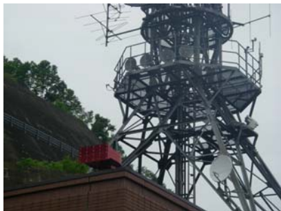
玉川ダム 放流警報施設
