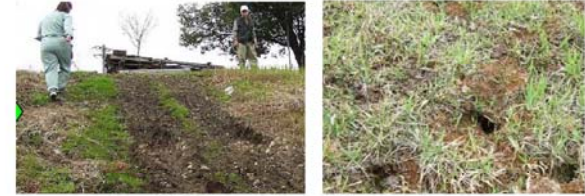
堤防変状状況（車輛による損傷、モグラ穴）
