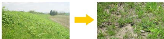
有害な植生（イタドリ等）の進入による堤防の裸地化
