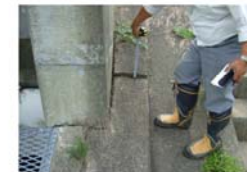
樋門・樋管の変状状況
