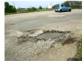
堤防の天端舗装補修前の状況
