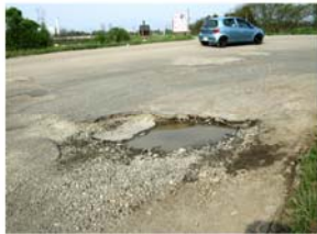
堤防の天端舗装補修前の状況
