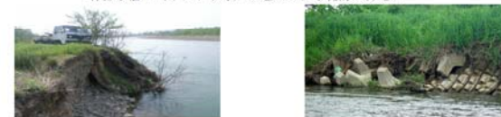
河岸崩壊の状況
