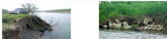
河岸崩壊の状況
