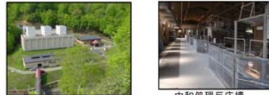
中和処理施設 (外観) 中和処理反応槽
