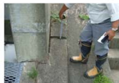
樋門・樋管の変状状況
