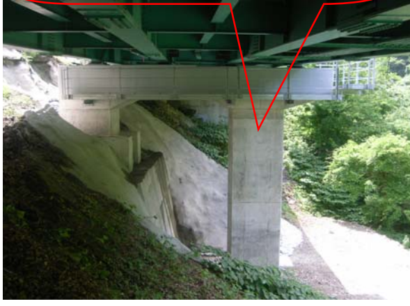
補強後の橋脚（P1）です。コンクリートにより幅を1.9mに広げました。また、新たに検査路も設置しています。
