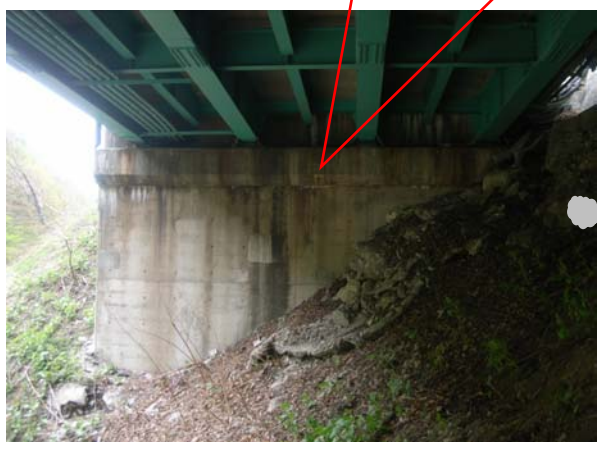
補強前の第二赤滝橋の橋台（A2）です。コンクリート劣化箇所が見られます。
