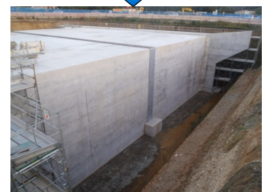
箱型トンネル本体の完了状況 (コンクリートは約3,700m 3 使用)
