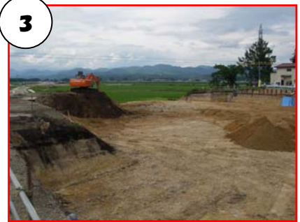
3 土掘り バックホウを使用し、大型ダンフ約3.450台分の土を掘りました。掘った土は、北側の盛土に有効利用しました。
