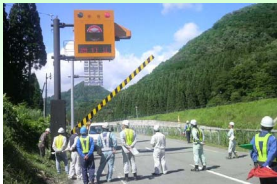
手動操作による遮断棒の下げ操作
