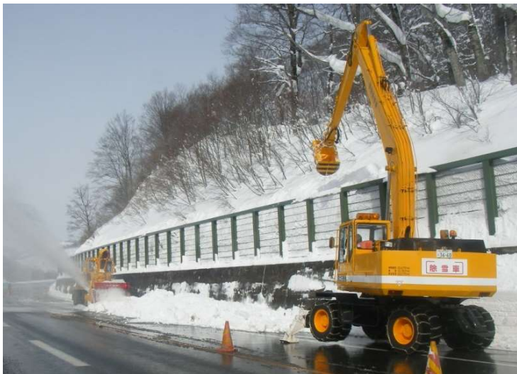
ロータリ除雪車&雪庇(せっぴ)処理車 雪庇処理車で道路脇に張り出した雪を落として ロータリ除雪車で遠くへ飛ばす作業をしています
