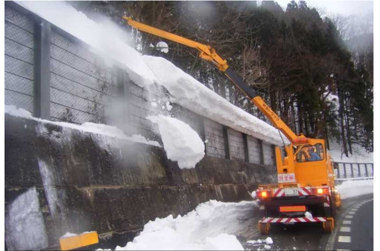
除雪トラック 除雪トラックについている装置で雪庇を処理します。
