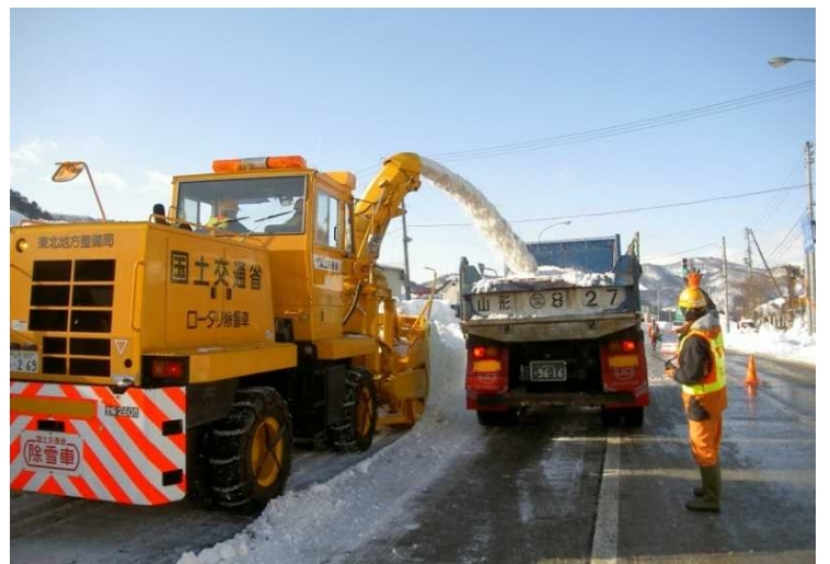
ロータリ除雪車&ダンプトラック 除雪で路肩にたまった雪を運び出し、道路の幅を確保します。
