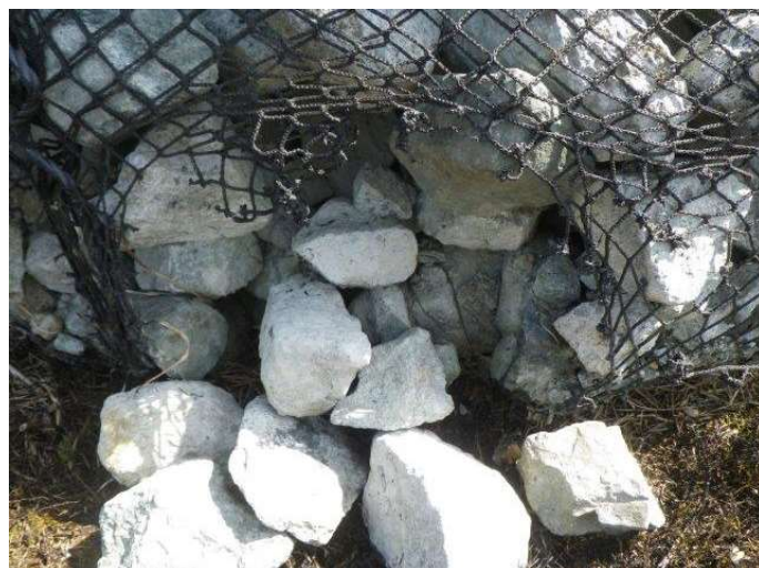
▲ 火災が起きた長崎大橋下流右岸の堤防側帯備蓄資材の袋詰玉石の袋が破けて、中の石が出てしまっている
