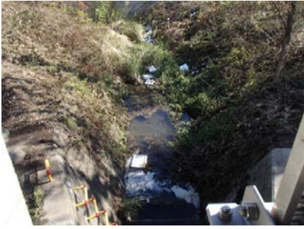
《31》 最上川左岸 No.100+ 中田悪水路排水樋管 堤外水路への発泡スチロールの投棄
