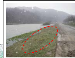
右岸 No.0~1 長井市河井 魚釣り等で低水護岸付近に ゴミの投げ捨てがみられる (注意看板設置中)
