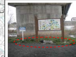
置賜白川 右岸 No.6 白川橋下 橋脚、案内看板付近に ゴミの投げ捨てがみられる
