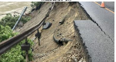
写真③ 国道47号 戸沢村高屋地区 (道路崩壊)
