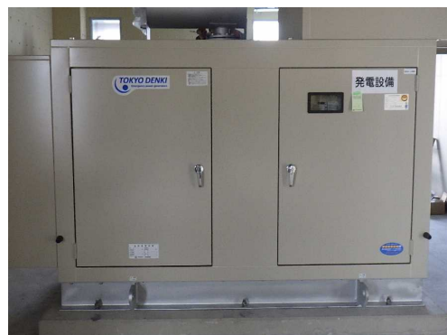
非常用電源装置
