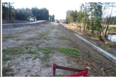
十日町西山中地区 (尾花沢方向)
