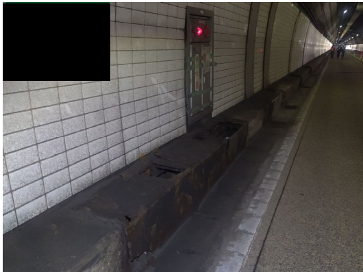
【損傷】 鋼材腐食
