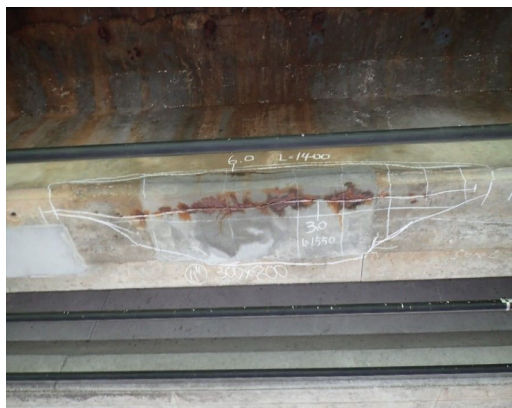
【損傷】主桁ひびわれ
