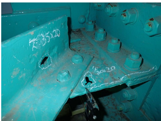
【損傷】 下横構・ガセットプレートの孔食
