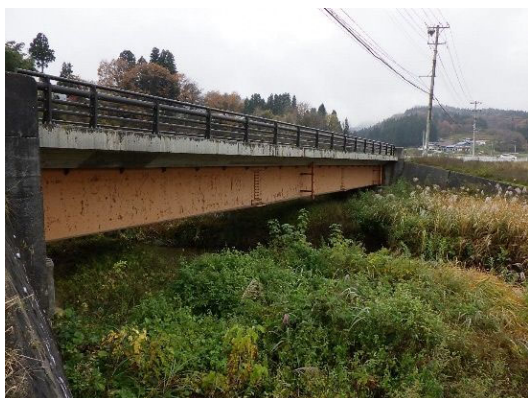
【損傷】鋼桁の塗膜劣化
