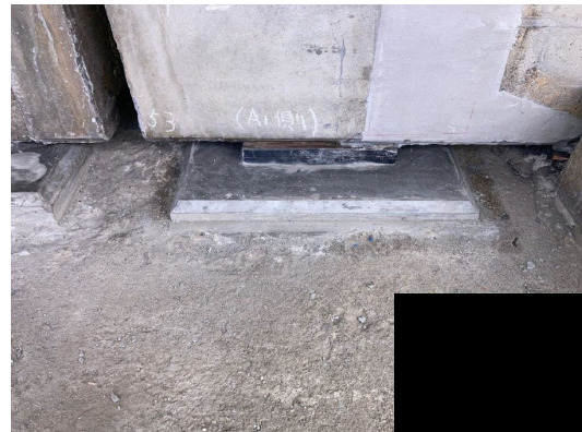
【対策】沓座補修
