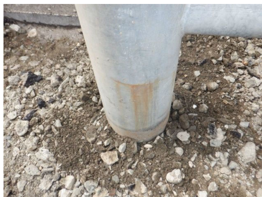
【損傷】支柱の腐食
