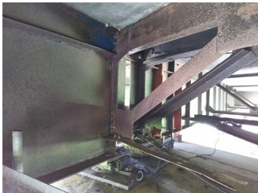
【損傷】主桁、支承の腐食
