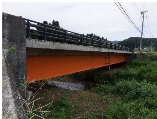
【対策】主桁再塗装
