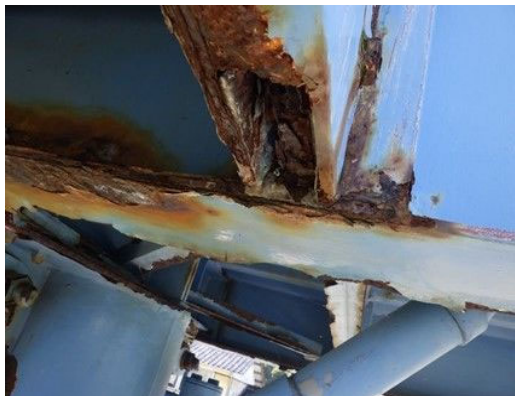
【損傷】上部構造接続部の腐食
