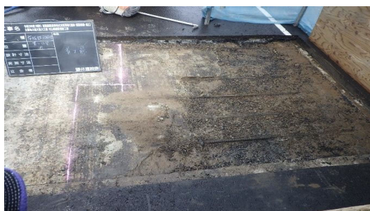
【損傷】床版の土砂化
