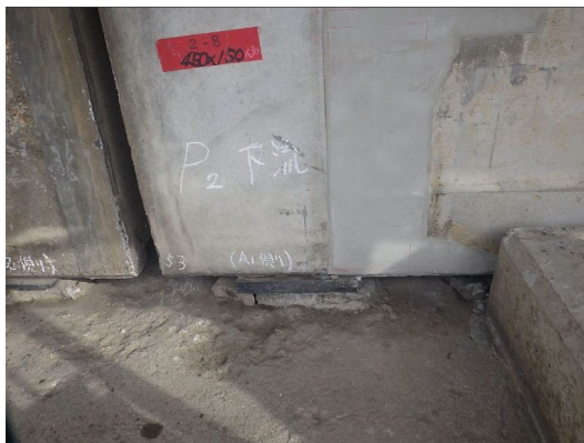
【損傷】沓座モルタルの欠損
