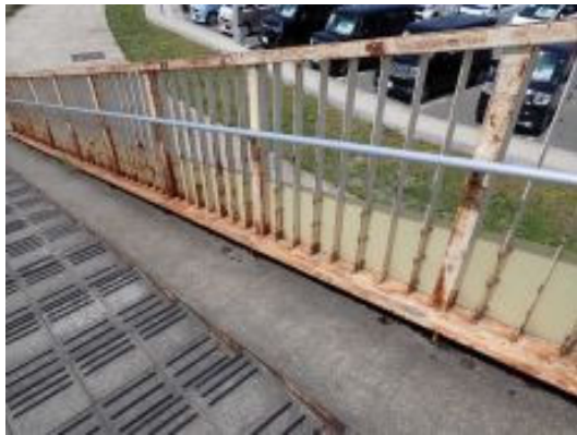
【損傷】鋼部材の経年劣化による腐食、防食機能の劣化
