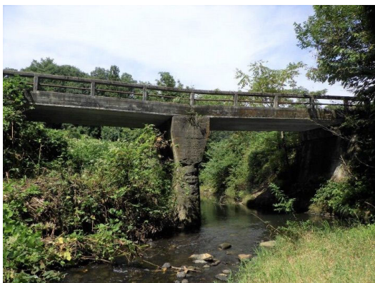
【損傷】橋脚の沈下
