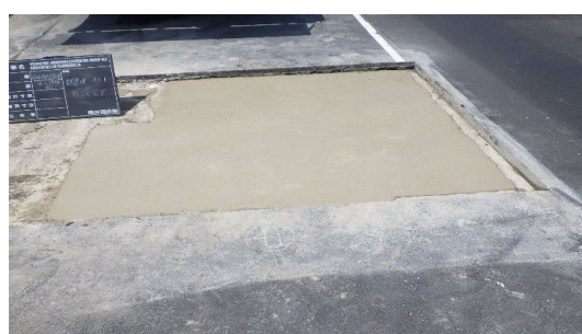
【対策】床版打ち換え
