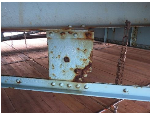
【損傷】鋼桁の腐食
