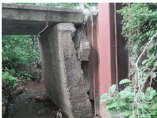
写真4-23 【損傷】橋台の傾斜
