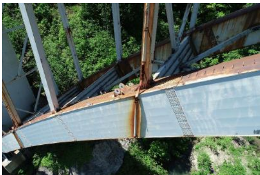
写真4-5 【損傷】アーチリブの腐食
