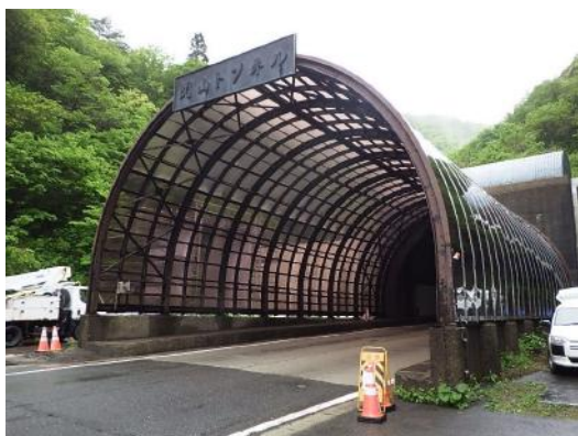
写真4-32 【損傷】 主梁等の腐食、破断、板厚減少
