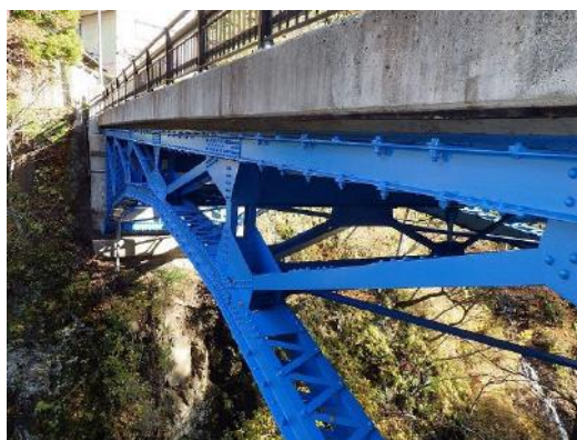
写真4-21 【対策】 塗装塗替、当て板補修
