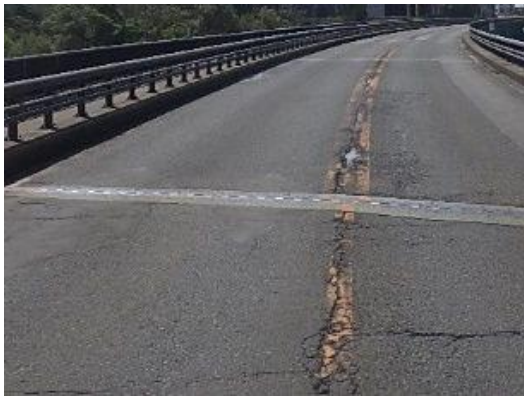
写真4-2 【損傷】伸縮装置の漏水
