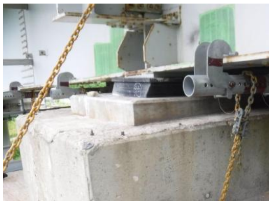
写真4-14 【損傷】 支承の機能障害（異常変形）
