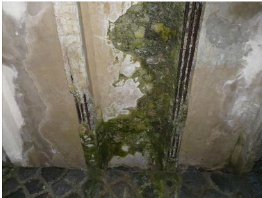
写真4-8 【損傷】主桁剥離、鉄筋露出
