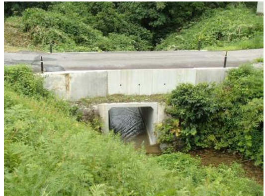
写真4-9 【対策】更新(ボックス化)
