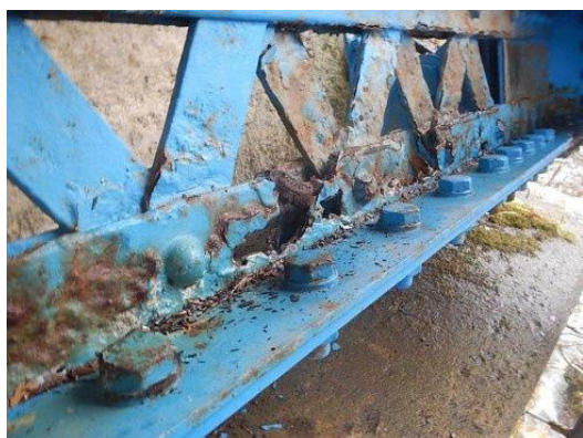
写真4-20 【損傷】鋼材の腐食
