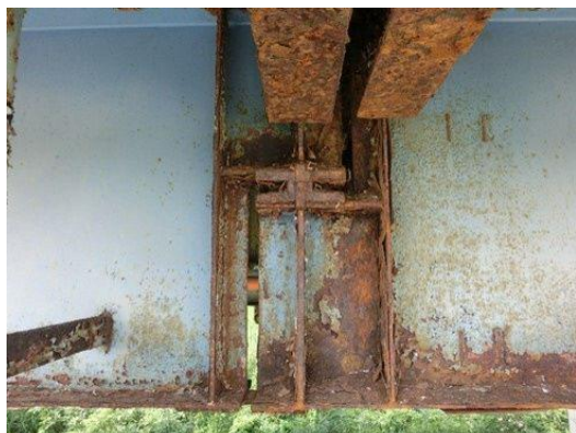
写真4-17 【損傷】主桁の腐食
