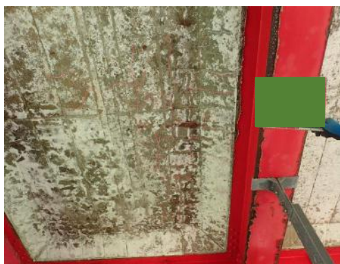
写真4-46 RC床版のひびわれ 錆汁を伴う漏水・遊離石灰
