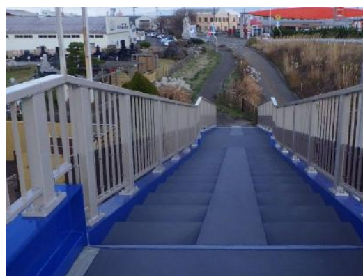
写真4-36 【対策】上部工架替え
