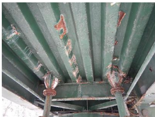
写真4-41 【損傷】 腐食・防食機能の劣化
