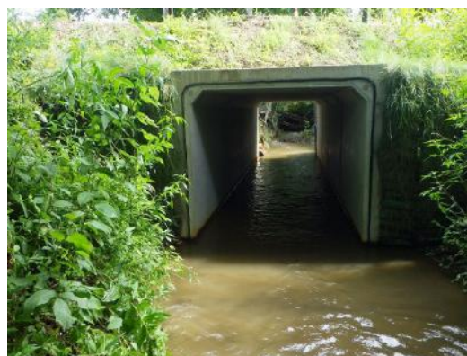
写真4-24 【対策】更新（ボックス化）
