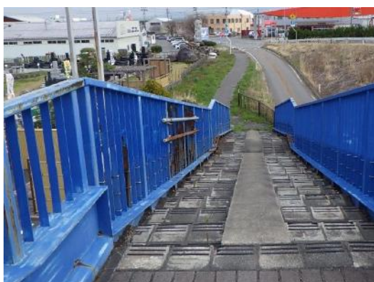
写真4-35 【損傷】 桁、床版腐食、防食機能の劣化
