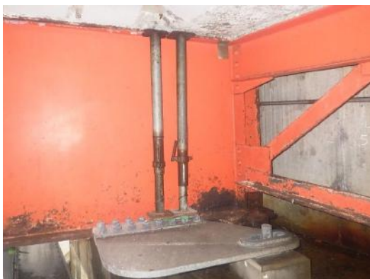
写真4-11 【損傷】主桁腐食
