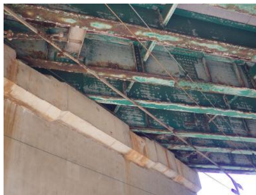
写真4-47 主桁の全般的な腐食
