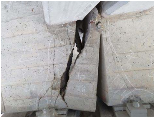
写真4-20 【損傷】主桁端部の欠損
