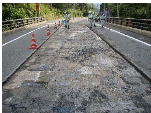
写真4-8 【損傷】床版劣化
