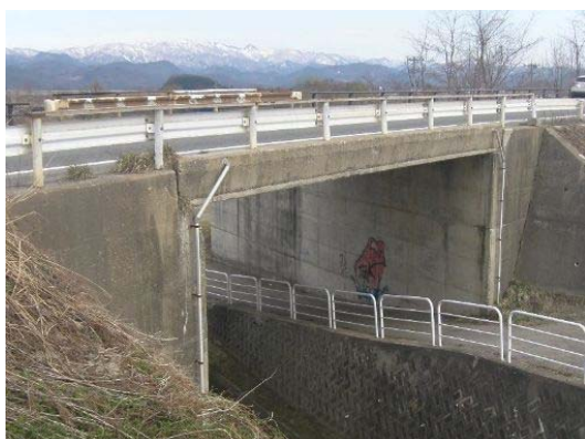
写真4-5 【損傷】 地覆のひびわれ、防護柵の腐食
