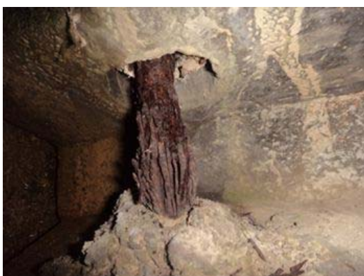
写真4-17 【損傷】アンカーバーの腐食
