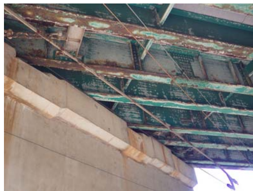
写真3-4 主桁の全般的な腐食
