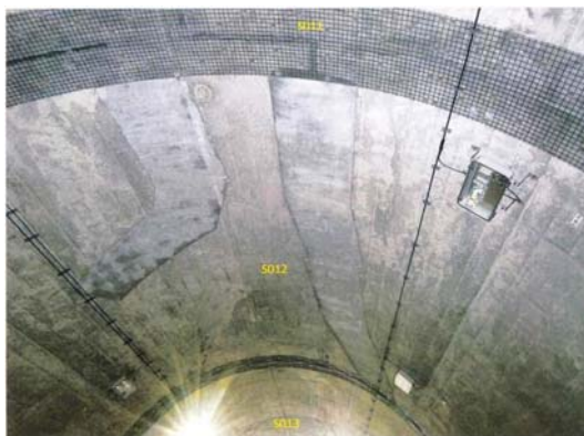
写真4-14 【損傷】覆工うき・はく離
