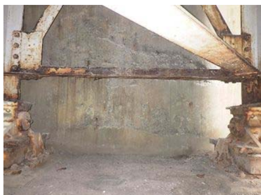
写真4-11 【損傷】 支承、鋼材の腐食
