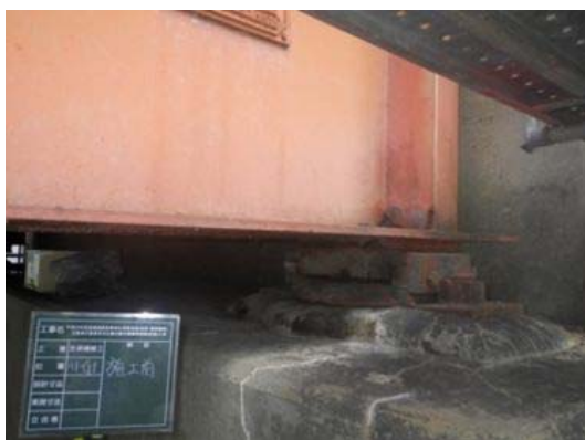
写真4-2 【損傷】支承、鋼材の腐食
