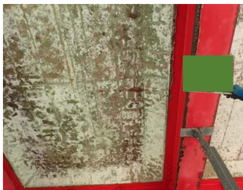
写真3-3 RC床版のひびわれ 錆汁を伴う漏水・遊離石灰
