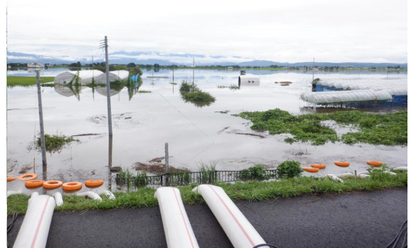
▲南陽市鬼神川水門 排水ポンプ車稼動状況
