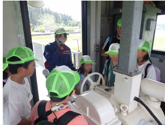
樋門操作体験
