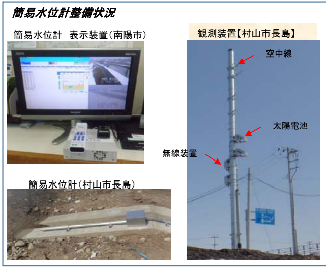
水リスクが高い箇所リアルタイムに水位を把握するための簡易水位計の設置
