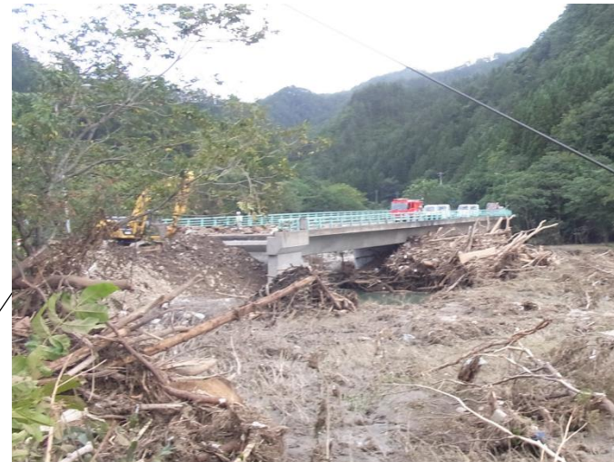
橋梁被害状況(乙茂地区)
