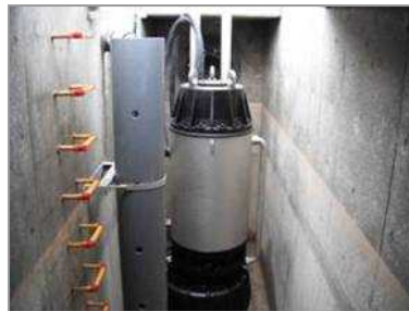
取水施設 (ポンプ)
