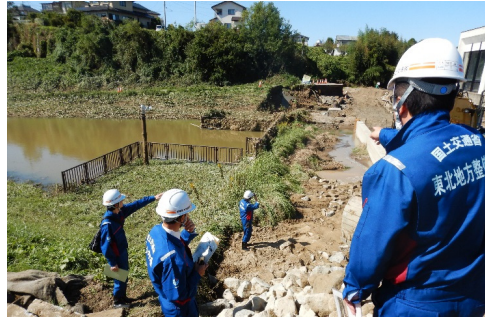
阿武隈川決壊箇所 調査状況
