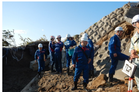
吉田川決壊箇所 調査状況
