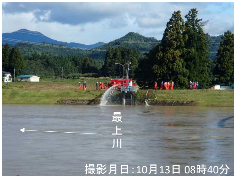
最上川 県道248号上伊佐沢川西線松川橋下流(185.7k付近) 排水作業状況
