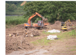
流木処理の状況
