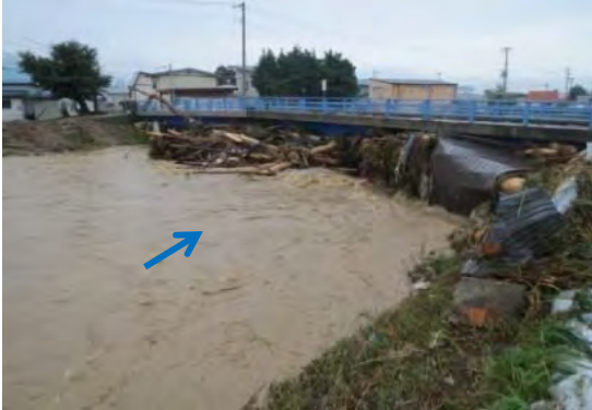
吉野川【南陽市】 平成26年7月の被害状況
