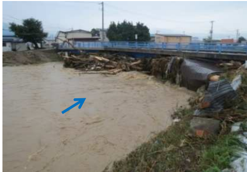
吉野川【南陽市】 平成26年7月の被害状況
