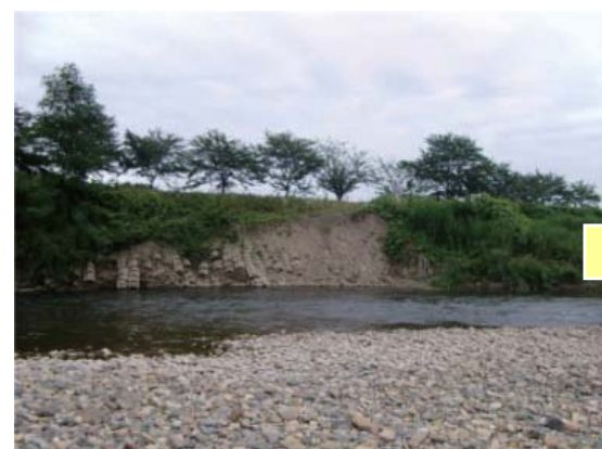
河岸補修前 [河岸損傷状況]
