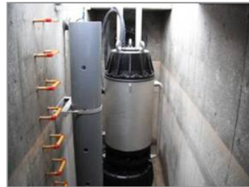
機械設備(ポンプ)
