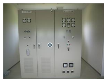
電気設備(岩ヶ袋工区)
