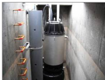
機械設備(岩ヶ袋工区)
