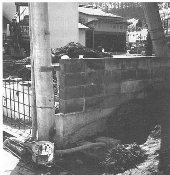
写真11 県道ぞいの湧水。側溝へポンプで排出中。 4.17 背景が砂丘。工事は地震にかかわらない。
