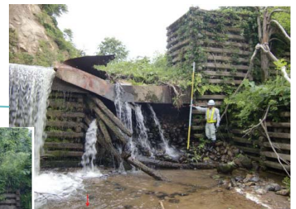
赤砂第1砂防堰堤損傷状況
