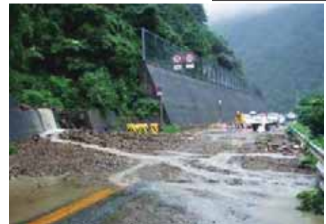
▲国道47号猪ノ鼻地区の被災状況
