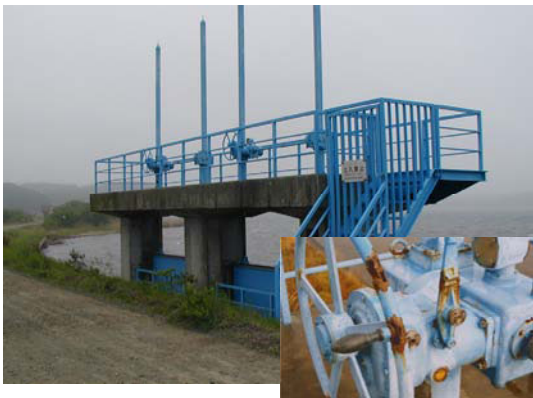
開閉器ハンドルの錆（中志第一排水樋管）
