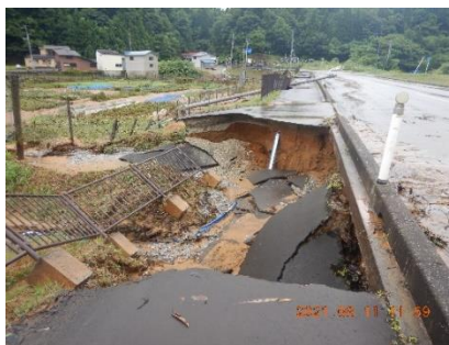
8月11日 むつ恐山公園大畑線 小目名地区 歩道崩落 被災状況 今後復旧を進めていく
