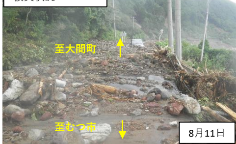
焼山崎～下風呂間 被災状況
