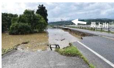
【国】最上川44.3km付近(堤防欠損状況)
