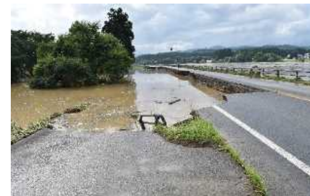
《最上川45.3k付近の浸水被害状況》
