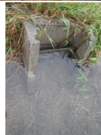
R6.7.25大雨時の水田貯留状況（鶴岡市）
