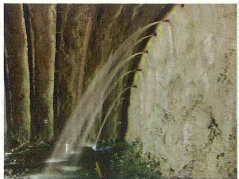
（トンネル内の湧水状況）
