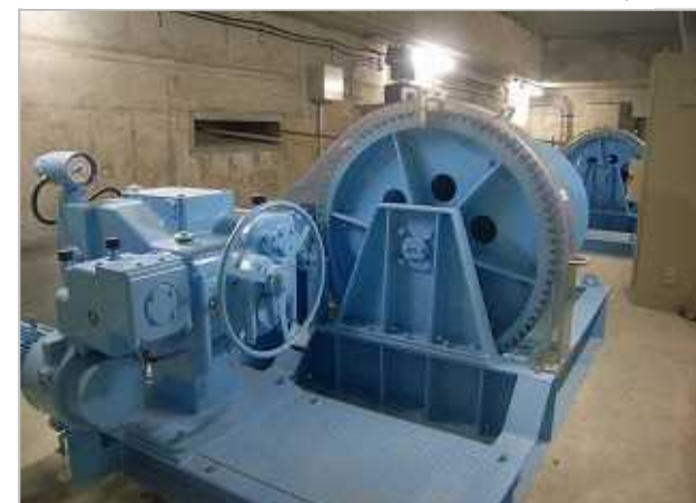
他ダムの事例 洪水吐き用ゲート開閉装置
