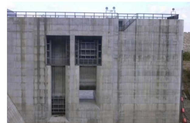
他ダムの事例 洪水吐き用ゲート
