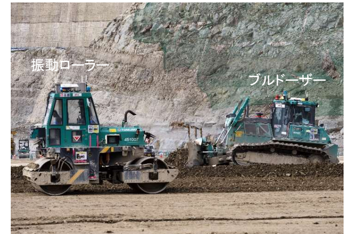
④CSG締め固め（転圧） CSGを75cm(3層)敷均した後、振動ローラーで締め固めを行います。この工程を繰り返して成瀬ダムを建設していきます。
