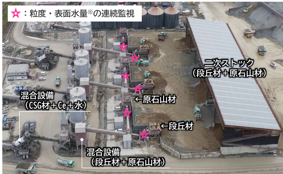
▲成瀬ダムのCSG製造設備（同様の構造を3系統配置）
